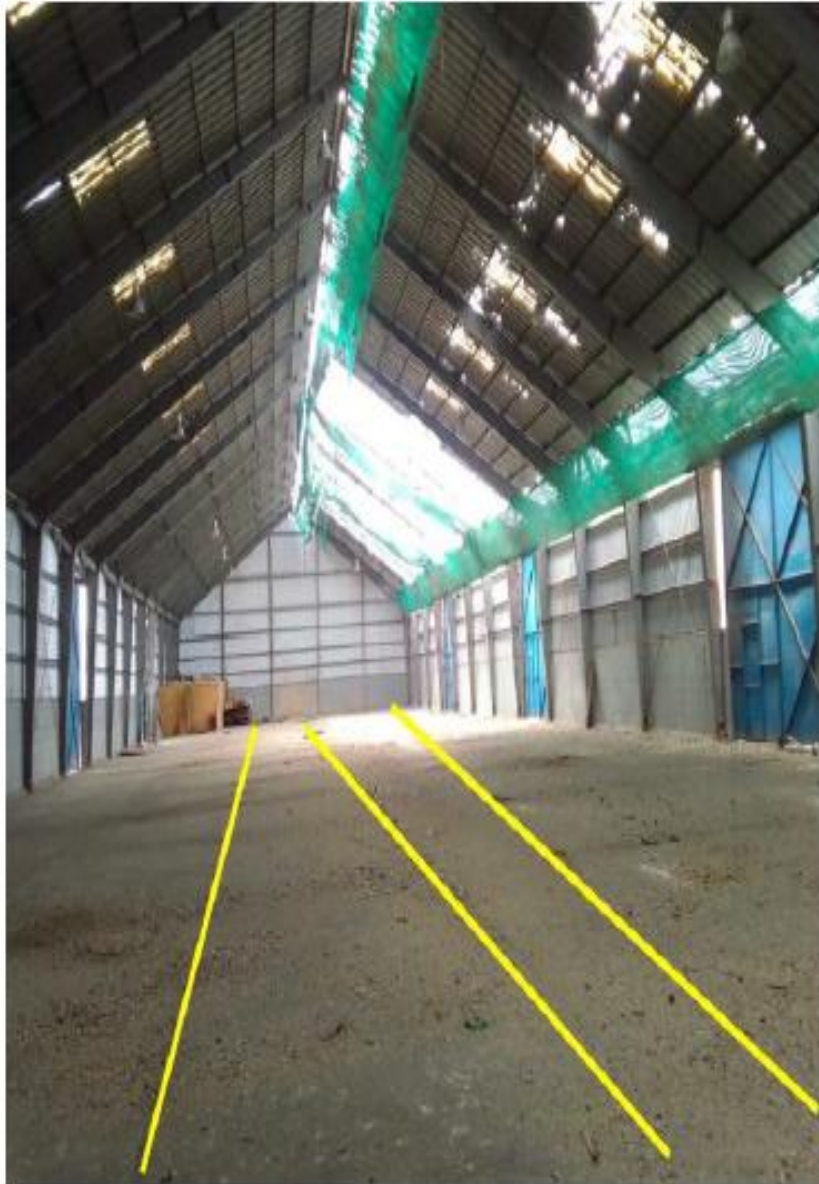
JUNTA DILATACION (04) REQUIERE TRATAMIENTO
