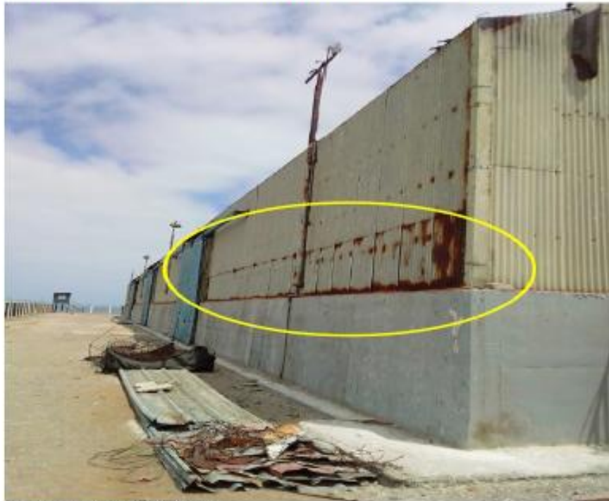
CALAMINAS LADO SUR EN MAL ESTADO
