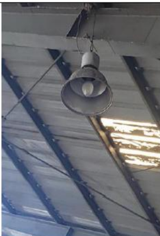
ILUSTRACIÓN 5 LUMINARIA HALÓGENA 400 WATTS TOTAL (24) CAMBIO POR LED SE SUGIERE DE 24 A (12)
