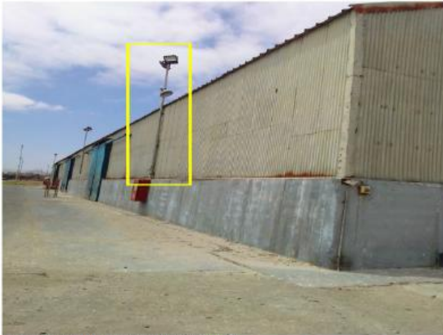
2 POSTES DE LUMINARIAS LED CON RESPECTIVO INTERRUPTOR
