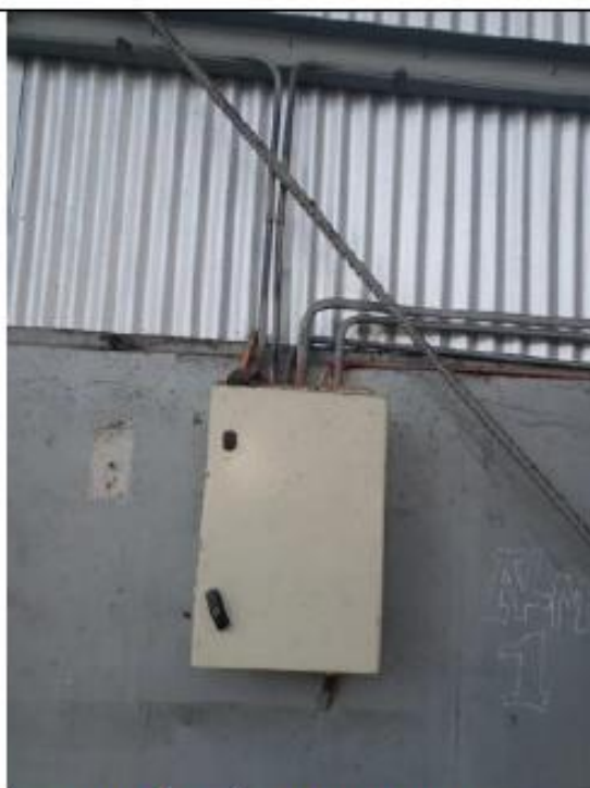
ILUSTRACIÓN 3 CAJA DE DISTRIBUCIÓN ELÉCTRICA TOTAL (01)
