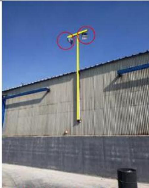
ILUSTRACIÓN 2 POSTES DE ILUMINACIÓN POSTE TIPO "T" EXTERIOR TOTAL (06) LUMINARIAS TOTAL (02)
