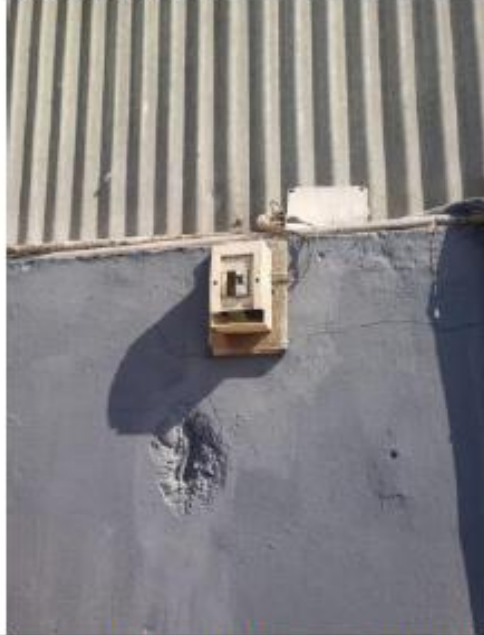
ILUSTRACIÓN 1 INTERRUPTOR DE ILUMINACIÓN POSTE EXTERIOR TIPO TERMO MAGNÉTICA TOTAL (06)
