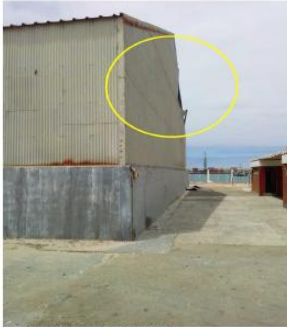
CALAMINAS LATERALES EN MAL ESTADO SI CAYERON DE SUS VERTICES
